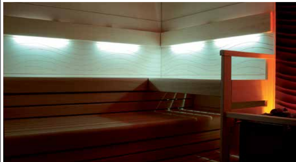
LED-Effektbeleuchtung in Rückenlehnen
